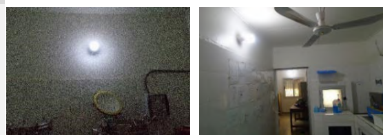
Photo 7. Éclairage inadapté dans la zone de travail.
