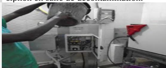
Photo 3. Coffret électrique exposé à l'eau.
