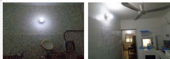
Photo 7. Éclairage inadapté dans la zone de travail.
