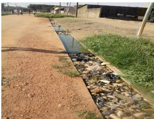
Photo 5 : Caniveau obstrué par les déchets solides au sous-quartier Forêt-Sacrée / Cliché : Tuo, Avril 2017
