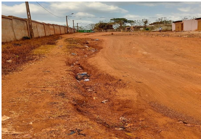
Photo 1 : L'état d'une route non revêtue au quartier Tazibouo université de Daloa
