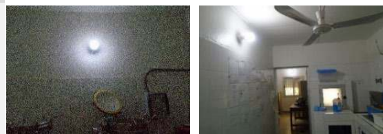
Photo 7. Éclairage inadéquat dans la zone de travail.
