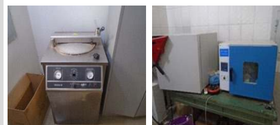
Photo 6 : Encombrement de la zone de travail par des équipements hors service.
